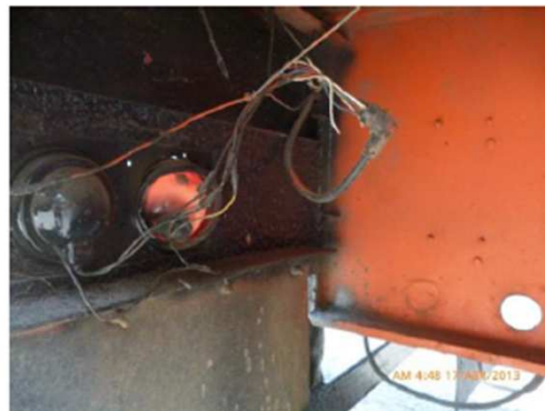
Cables empatados y pelados
