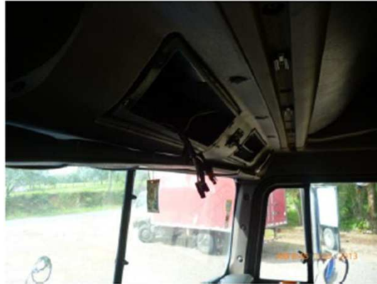
Instalaciones electricas fuera de uso
